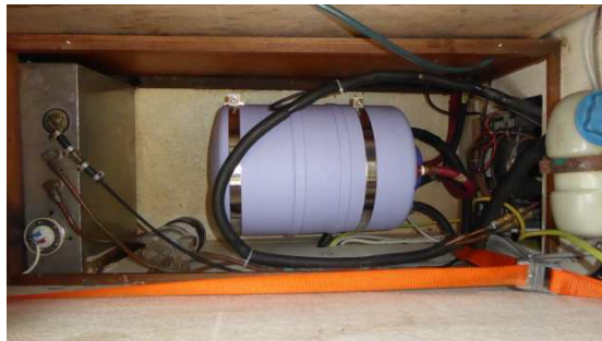
der neue Boiler
